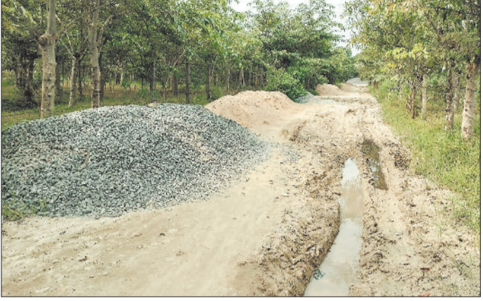
अधूरी सड़क जिसमें पड़ी निर्माण सामग्री।
